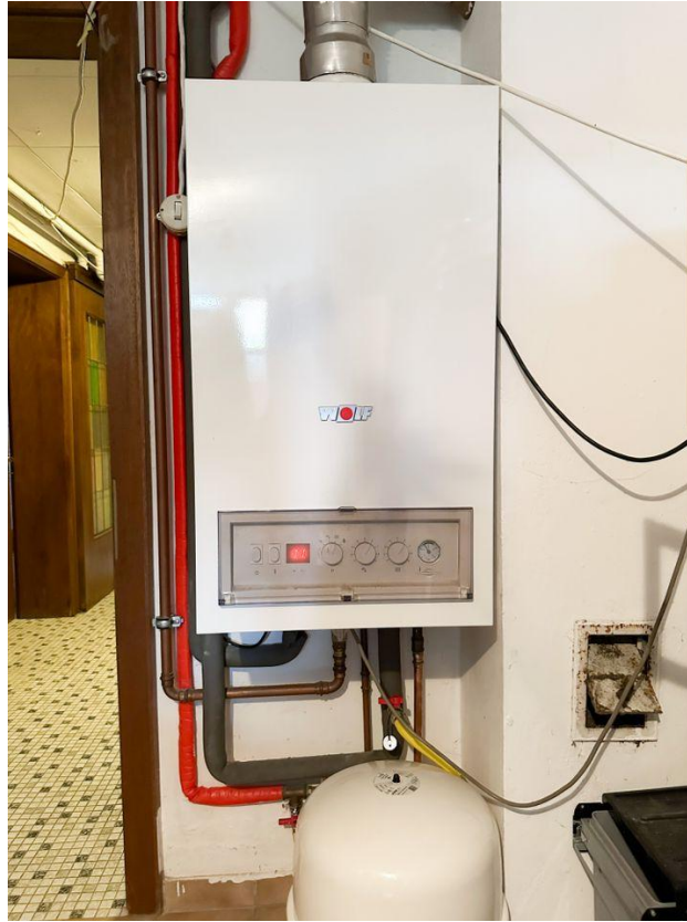
KG Heizung EG
